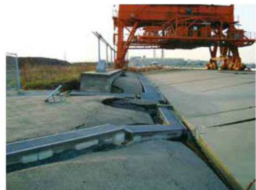
小名浜港5号埠頭岸壁 (-1.2m) の被災状況
