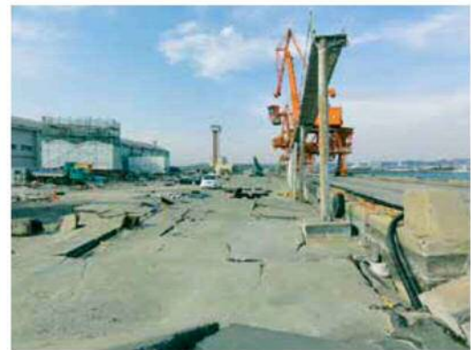
小名浜港3号埠頭3-2岸壁における被災状況
