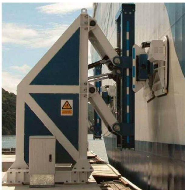
図 4-4-9 自動係船設備の設置事例 (日本作業船協会HPより) 6)
